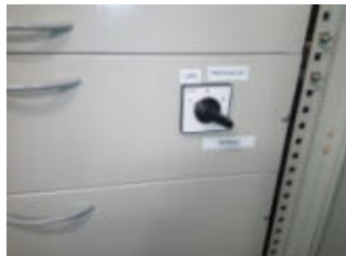
Obr. 11: Přepínač bypass UPS v normálním provozu
