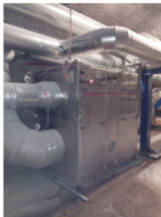
Obr. 6: Zařízení vzduchotechniky centrální jednotka VZT. Jednotka je vybavena 2 ks ventilátory.
