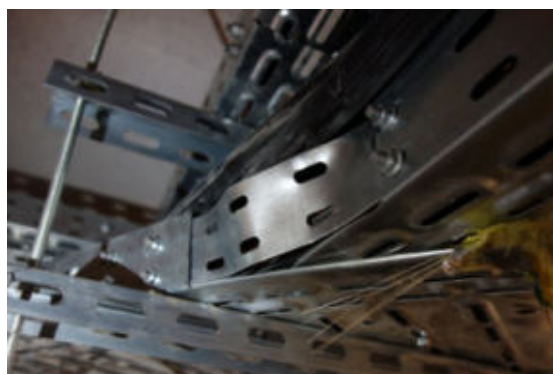
Prohnutá a ostrá část žlabu, která je v přímém dotyku s kabely, které jsou již částečně poškozeny
