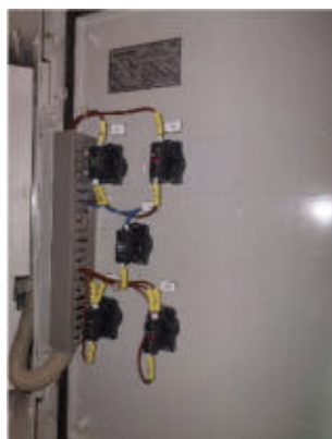
Obr. 3: Rozváděč přípojného místa pro vnější napájení zařízení
