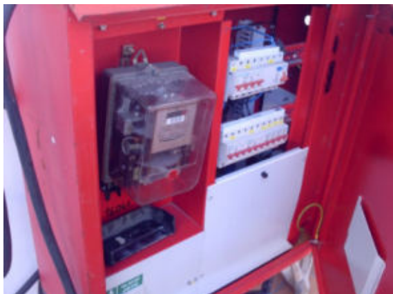
Obr. 11: Vybavení staveništního rozváděče.
