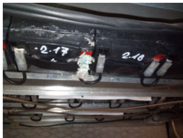
Obr. 17: Stav vadných baterií UPS
