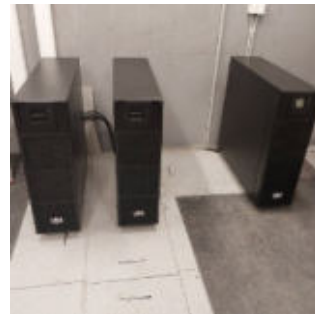
Obr. 15: Příklad UPS s bateriovými boxy
