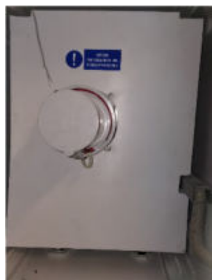
Obr. 4: Rozváděč přípojného místa pro vnější napájení zařízení
