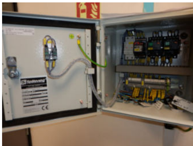
Obr. 1: Rozváděč v rozvodně
