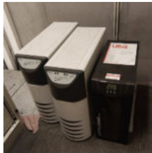
Obr. 14: Příklad UPS s bateriovými boxy
