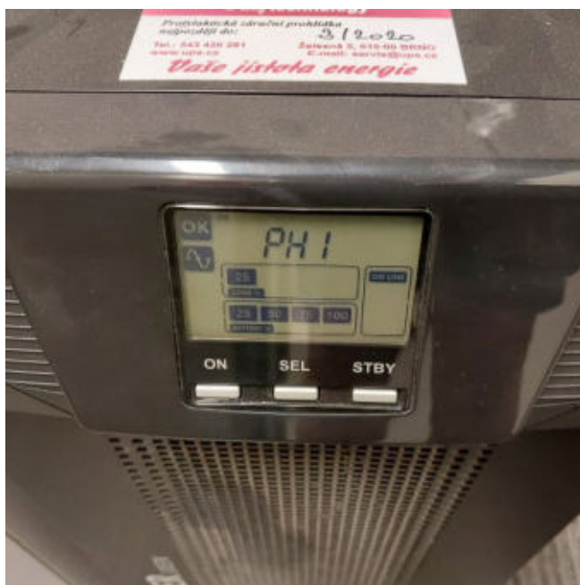
Obr. 13: Detail displeje UPS
