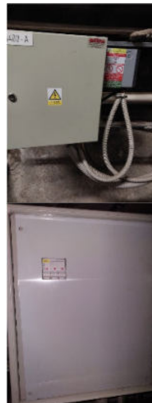
Obr. 7: Koncový rozváděč pro ventilátor a měnič ventilátoru
