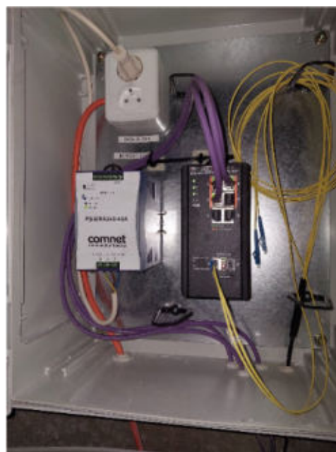
Obr. 15: Vnitřní vybavení datového rozváděče
