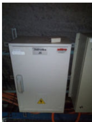
Obr. 2: Kabelové vedení přívodu je v kolektorové části ukončeno v rozváděči vzduchotechniky, kde jsou rozděleny vývody na jednotlivé sekce VZT.
