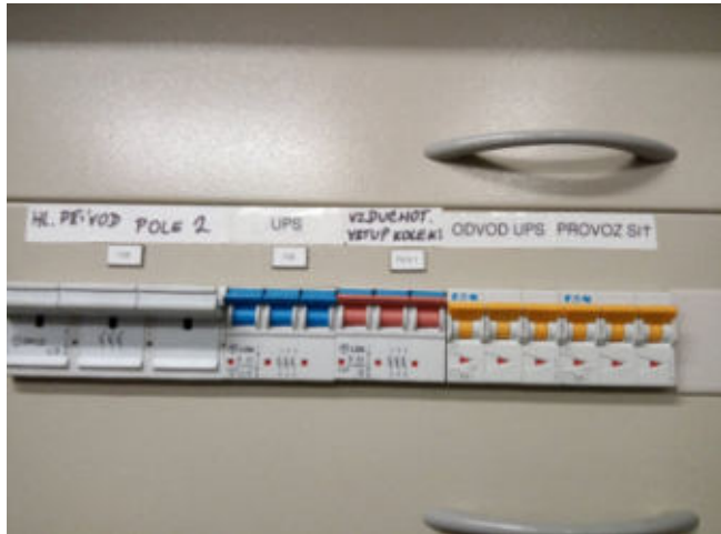
Obr. 12: Příklad jistění zařízení UPS v rozváděči
