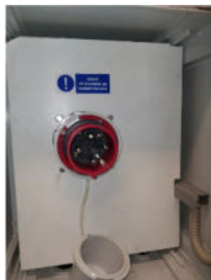
Obr. 2: Rozváděč přípojného místa pro vnější napájení zařízení
