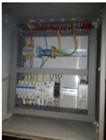
Obr. 3: Vnitřek rozváděče pro jistění obvodů VZT
