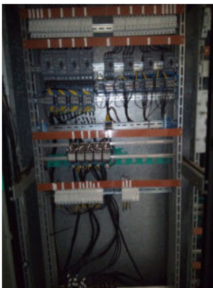
Obr. 3: Rozváděč pro ovládání vzduchotechniky po rekonstrukci, provedené výměnou opotřebovaných dílů:
