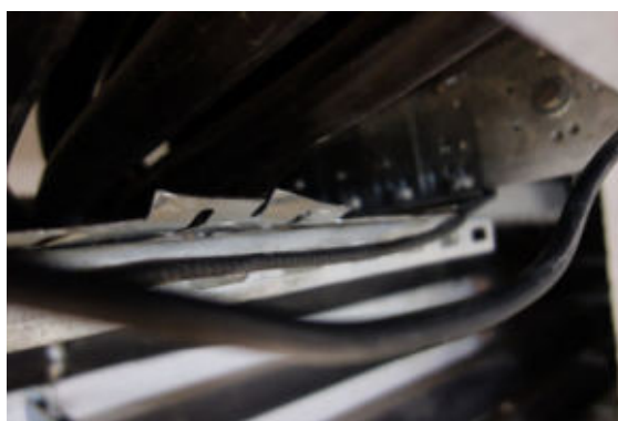
Detail ostré hran, kde je vzpadlá ochranná guma.
