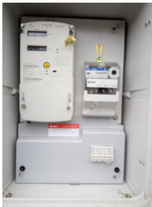
Obr. 6: Elektroměrový rozváděč přímého měření
