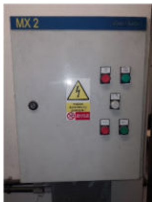
Obr. 1: Rozváděč přípojného místa pro vnější napájení zařízení
