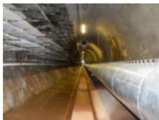
Obr. 8: Ventilátor pro vzduchotechniku v kolektorové síti: pohled kolektorové části s vybavením ventilátorem
