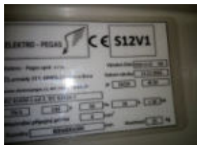
Obr. 5: Štítek rozváděče vzduchotechniky
