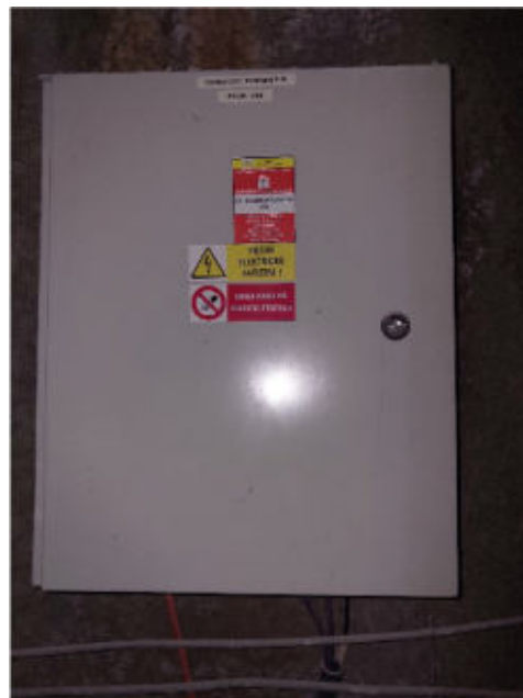
Obr. 14: Příklad datového rozváděče
